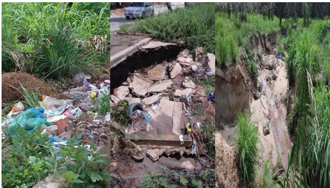
Figura 20 – Lixo e erosão no residencial Santa Teresinha.
