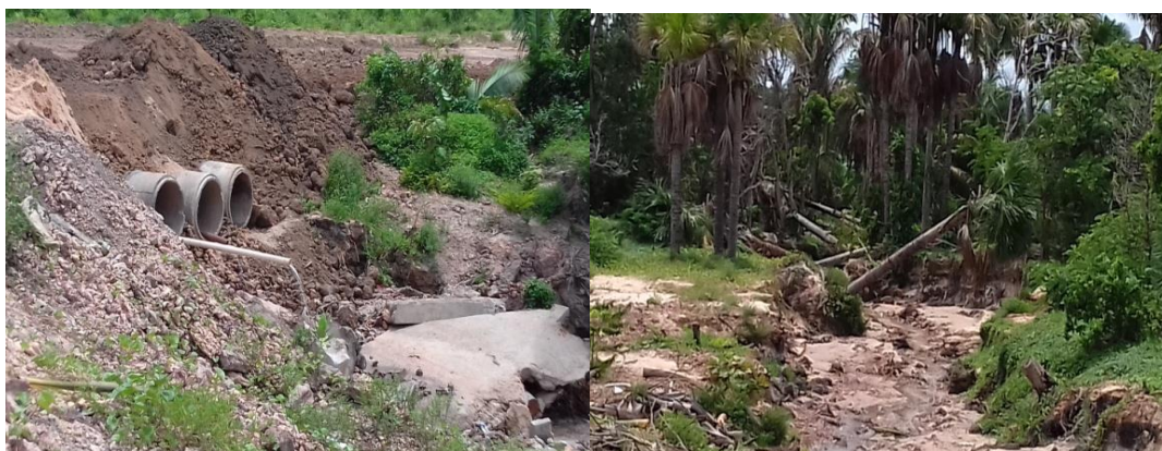
Figura 17 – Sistema de drenagem e erosão no residencial Vila Paraíso.
