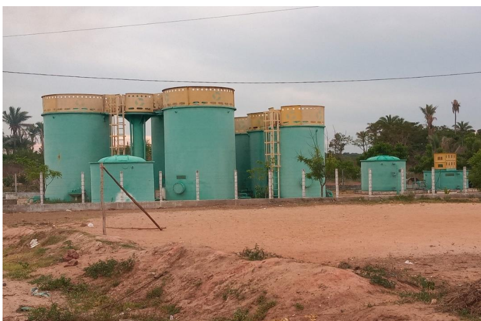
Figura 22 – Estação de tratamento de esgoto Vila Paraíso e filtro biológico
