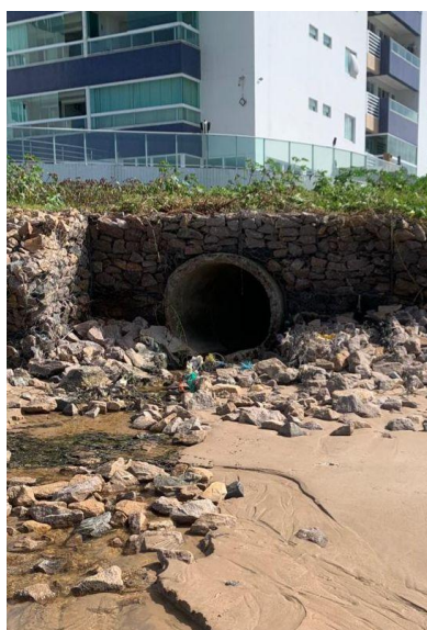
Figura 3 – Lixo acumulado entre as estruturas de contenção na praia do Bessa.
