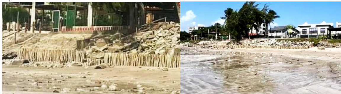
Figura 1 – Estruturas de contenção na praia de Camboinha. a) Estrutura de paliçada e enrocamento com fragmentos deslocados pela maré, representando risco aos banhistas. b) Construções costeiras utilizando estruturas de contenção.
